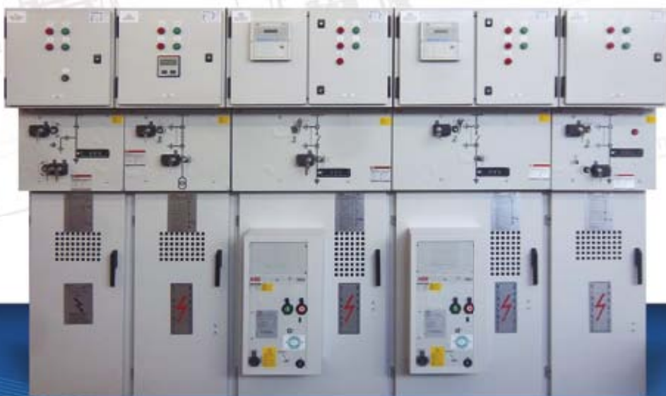
ΠΙΝΑΚΑΣ ΜΕΣΗΣ ΤΑΣΗΣ 20KV
